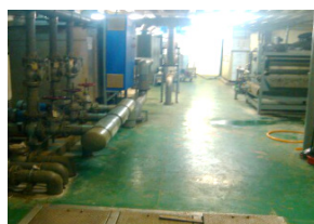
污水處理場回收雨水
