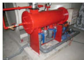
雨水回收設備
